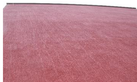
Schlagregen an einem Gebäude (© OST)
