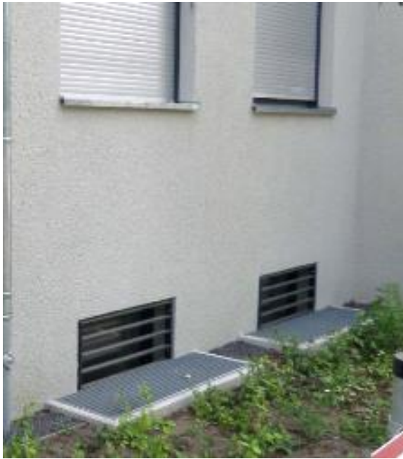
Abbildung 57: Über Lichtschächten befindliche verzinkte Fensterbänke in Testgebiet B
